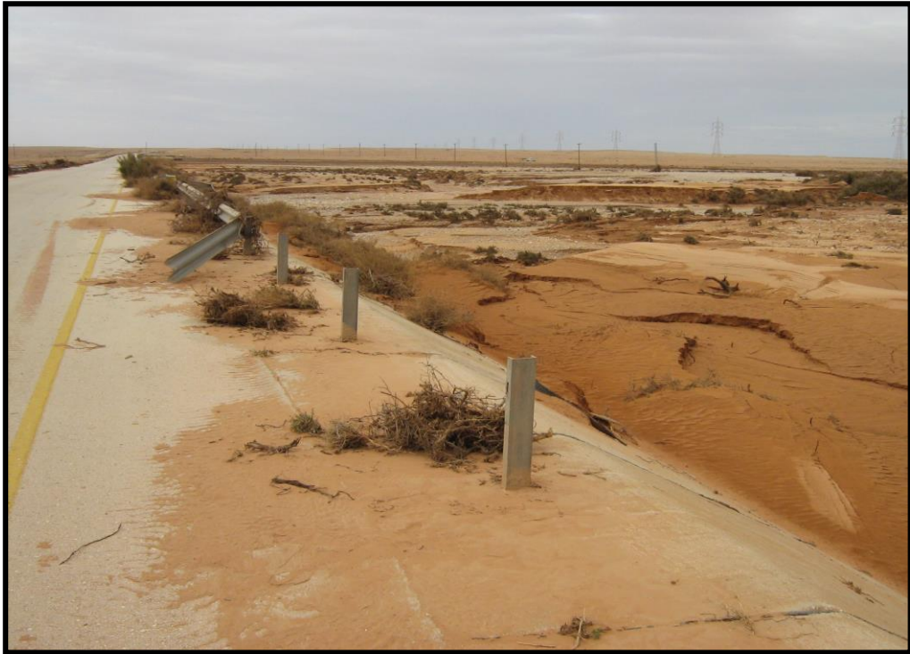
صورة (6-24) اقتلاع الحماية الجانبية للطريق بفعل التعرية المائية طريق (الخروبة - المخيلي)
